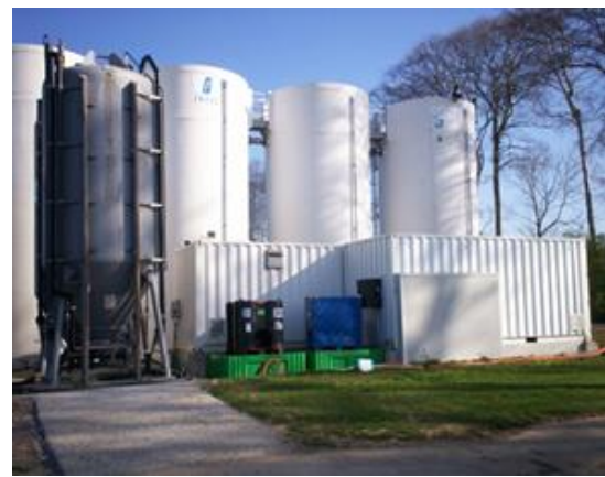
Figure 7 : Container métallique dédié aux microturbines de cogénération (Source : RA 2015)
