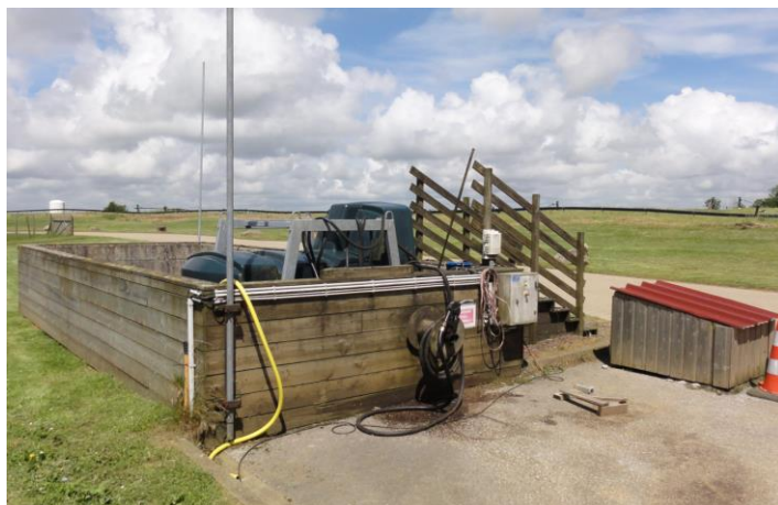
Figure 4 : Photo de la cuve à hydrocarbures (Visite BURGEAP du 10/06/2016)
